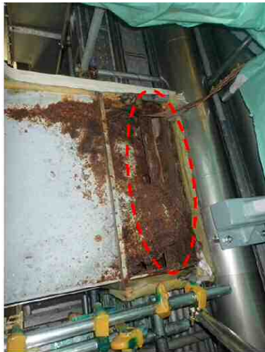
腐食孔 約 100cm×約 30cm
