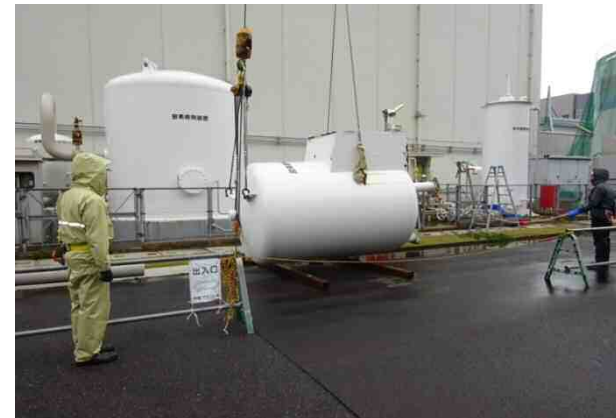
放射性物質による汚染のない設備の解体撤去 (タンクの吊り上げ)
