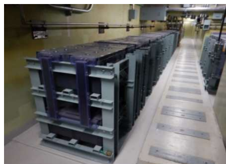
図35 蓄電池（バッテリー）
