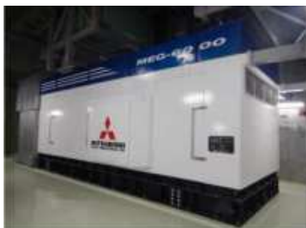
図34 ガスタービン発電機
