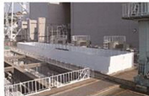
海水系ポンプエリアの防水壁
