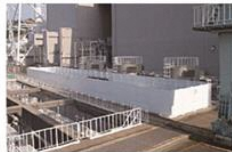
海水系ポンプエリアの防水壁
