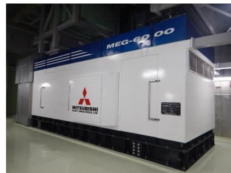
ガスタービン発電機 外観
