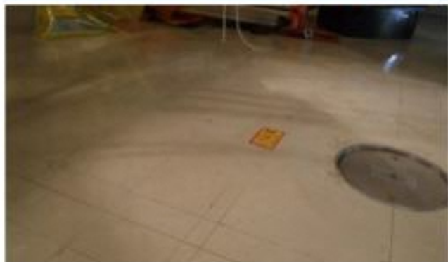
コリウムシールドの設置状況（2号機）
