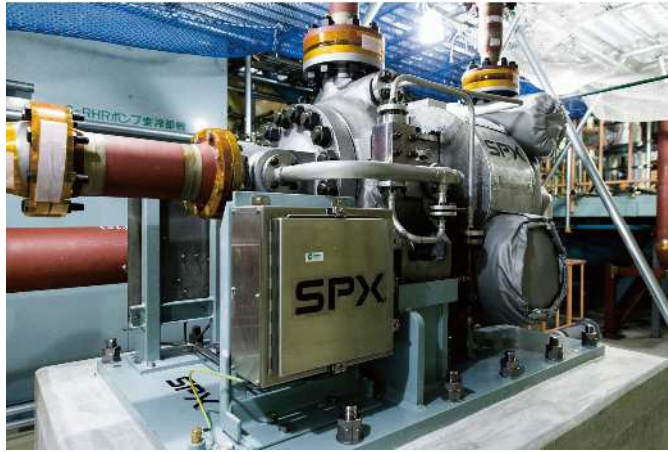
<高圧原子炉代替注水ポンプ>
