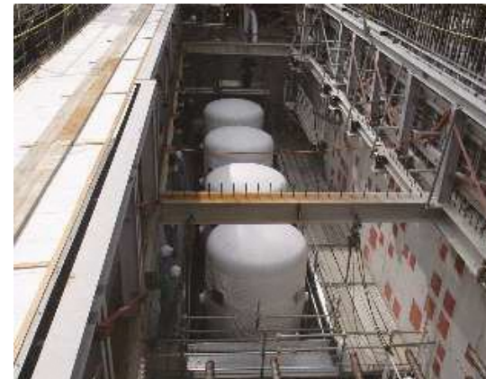
＜フィルタ付ベント設備＞
