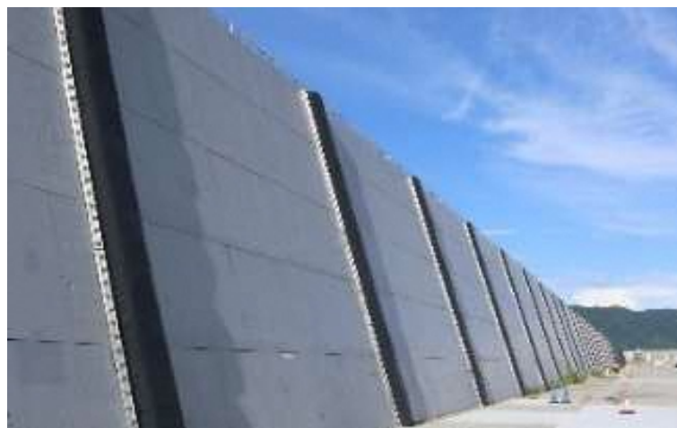
<防波壁(海拔15m、延長1.5km)>
