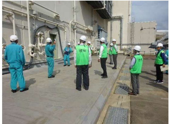
(低圧注水接続口)
