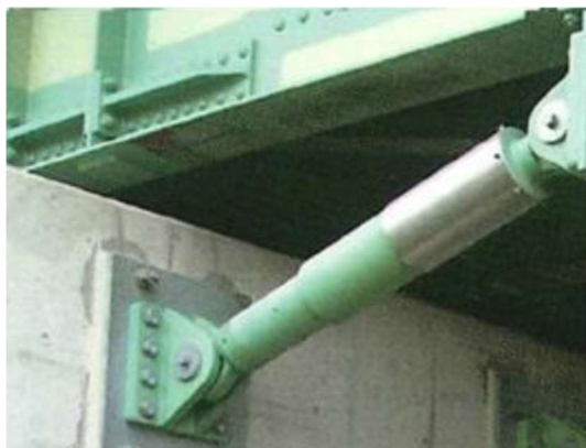
図9 単軸粘性ダンパ（橋梁への設置例）
