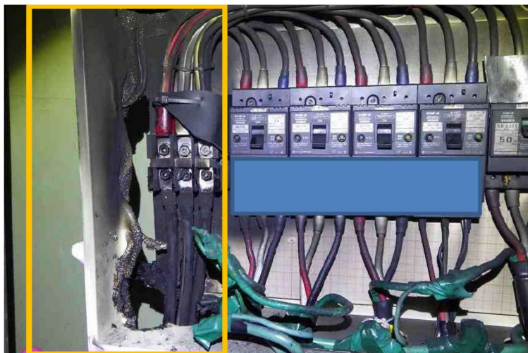
火災が発生した仮設分電箱
