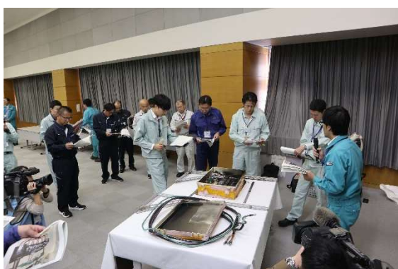
火災が発生した仮設分電箱
