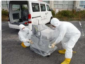
可搬型モニタリングポストの設置
