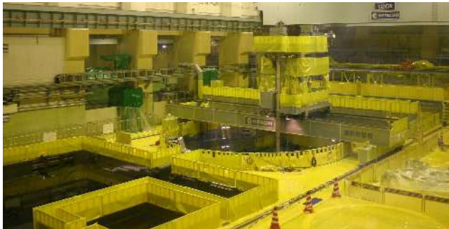
オペレーションフロア全景
