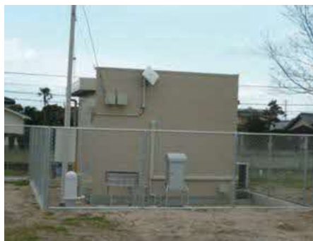
固定局の外観
