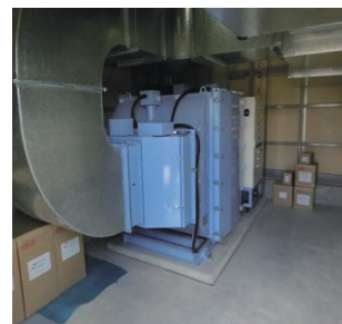
非常時外気取入ユニット （光洋の里）
