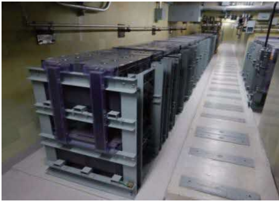
蓄電池（バッテリー）
