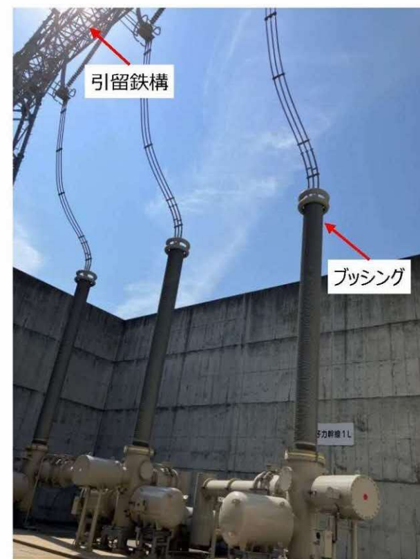
送電線引込部 (500kV開閉所の例)
