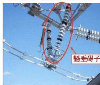
【220kV第二島根原子力幹線】
