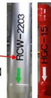
配管の識別 (原子炉補機冷却系等の例)
