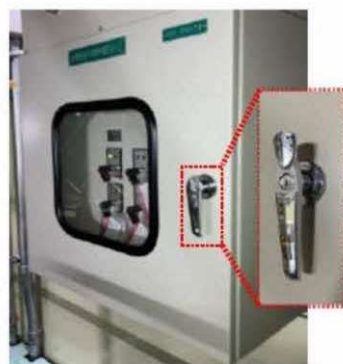
現場盤の施錠
