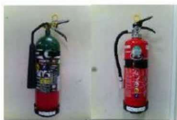
消火器設置状況
