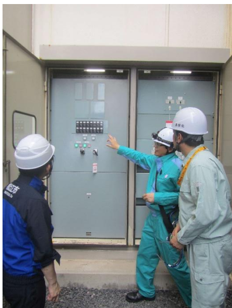
制御盤の確認
