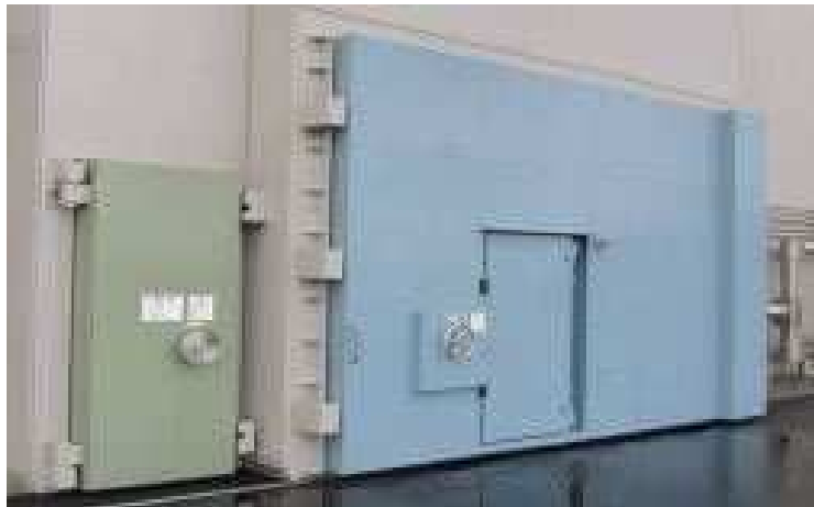
▲ 3号機建物外壁に設置した水密扉
