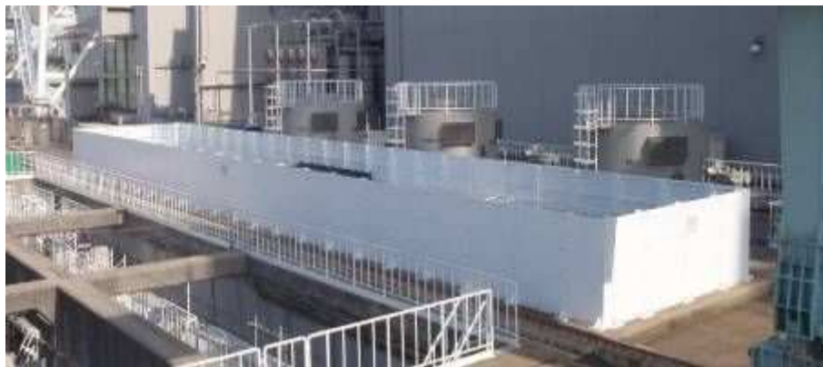
2号機原子炉補機海水ポンプエリアに設置した防水壁
